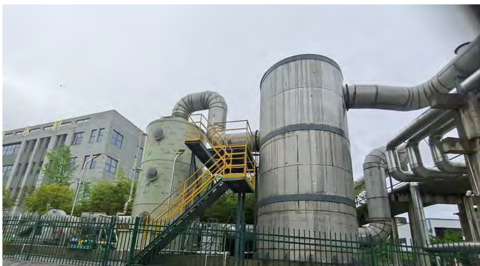
图 2: 高浓度废气治理设施 RTO
