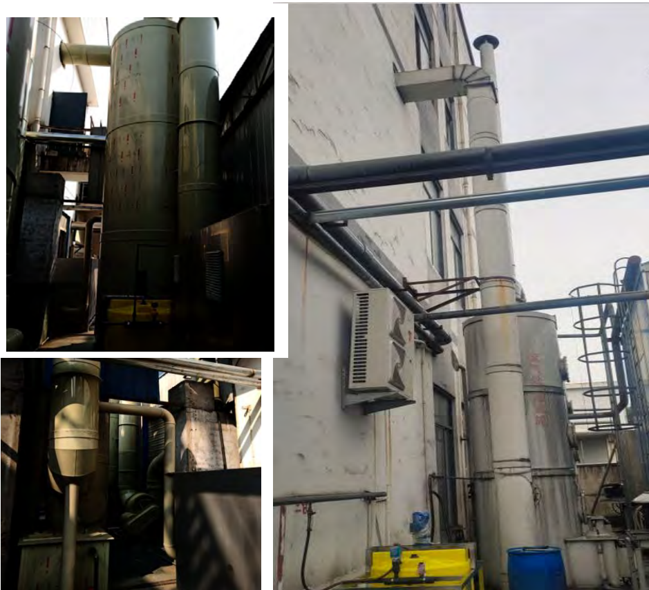
图 1：低浓度废气治理设施
